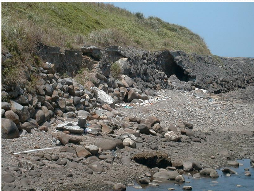
圖五十、河口護岸受沖石破壞之情形
